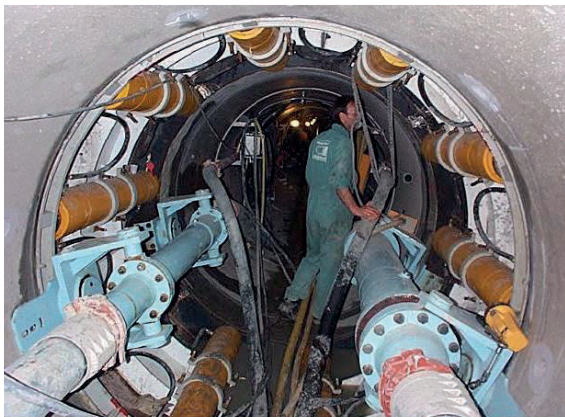
Kontrollgang Zwischenpressstationen (Quelle: Herrenknecht)
